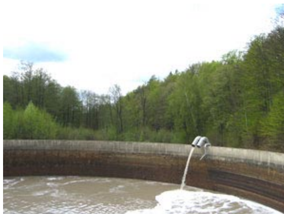
Utjämningsbassäng 1 vid avloppsreningsverket vid enheten i Perstorp.
