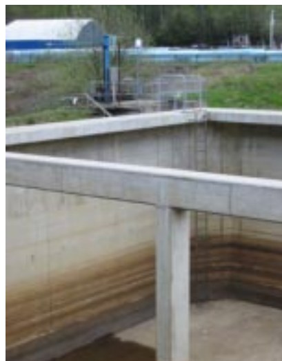
Utjämningsbassäng 2 vid avloppsreningsverket vid enheten i Perstorp.
