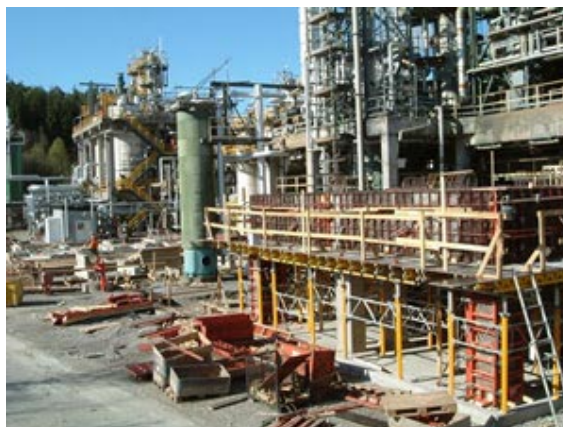
Omfattande byggnadsarbeten pågår vid enheten i Stenungsund inför övergång till naturgas, som ersättning för eldningsolja.
