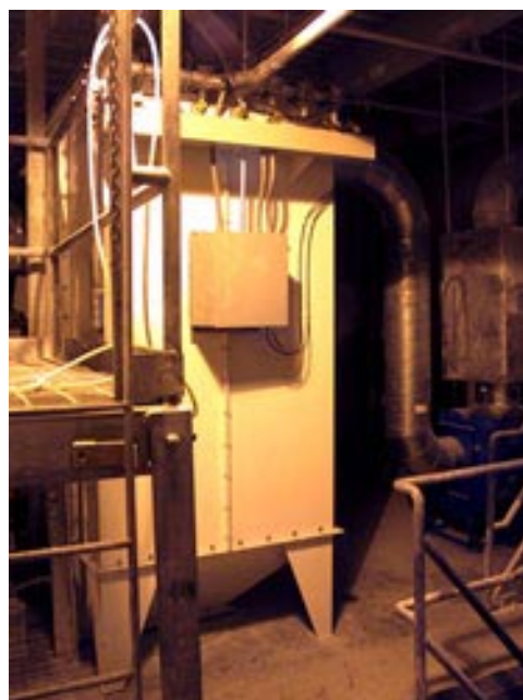
Enheten i Florence, USA, har genomfört ett större stoft-projekt, som kommer att innebära förbättringar både avseende utsläpp av stoft till atmosfären och avseende återvinning/återanvändning av material.
