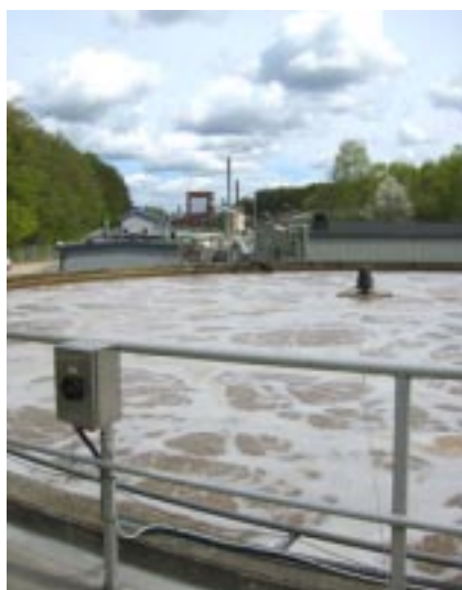
Luftningsbassäng 2 vid avloppsreningsverket vid enheten i Perstorp.
