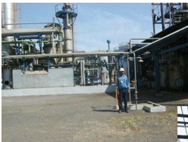
Framför formalinfabrik efter genomförda åtgärder: Nöddusch är installerad. Personalen har uniform, skyddskor och hjälm.
