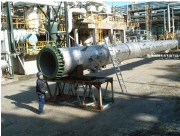
Enheten i Stenungsund förbereder byte av eldningsolja mot naturgas, som råvara i syntesgasanläggningen.
